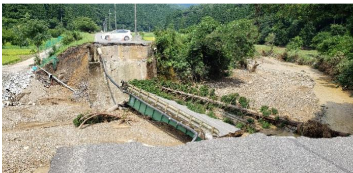
大桐地区への道路の橋の崩落現場徒歩で移動
