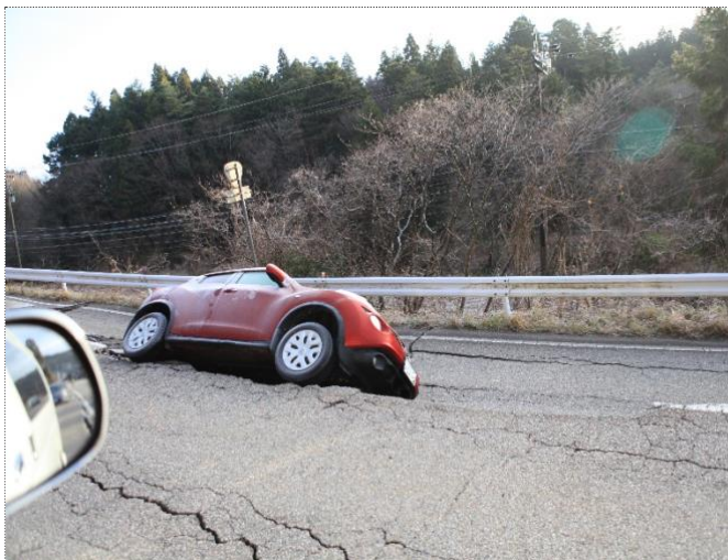
道路の段差・亀裂状況
