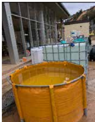
写真2 生活用給水槽(手前より3台あり)
