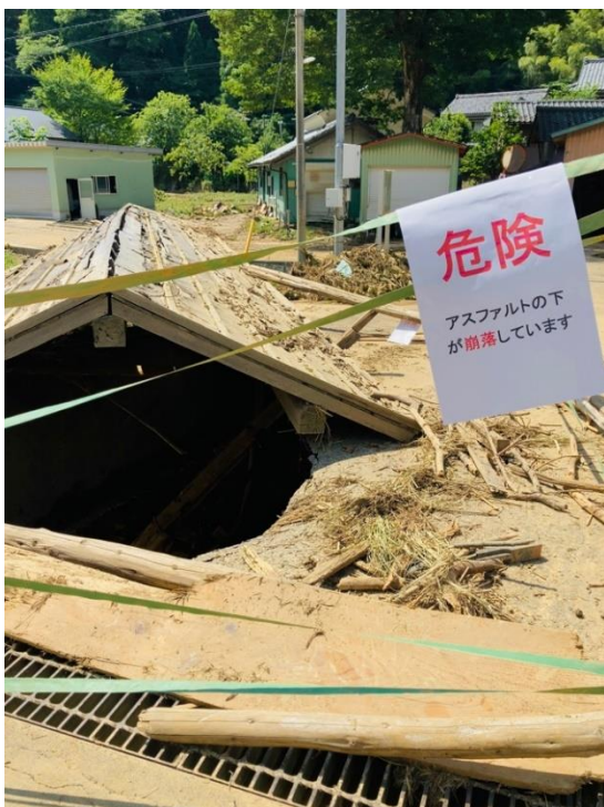
写真3：孤立集落の崩落した橋
