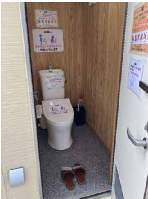
避難所仮設水洗トイレ
